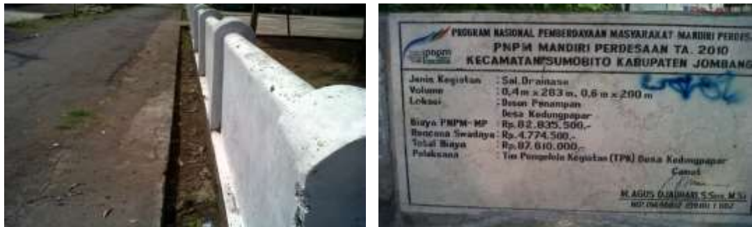
Gambar 1.4 Bantuan Saluran Drainase dari PNPM Mandiri Perdesaan di Dusun Penampian Desa Kedungpapar Tahun 2010 41
