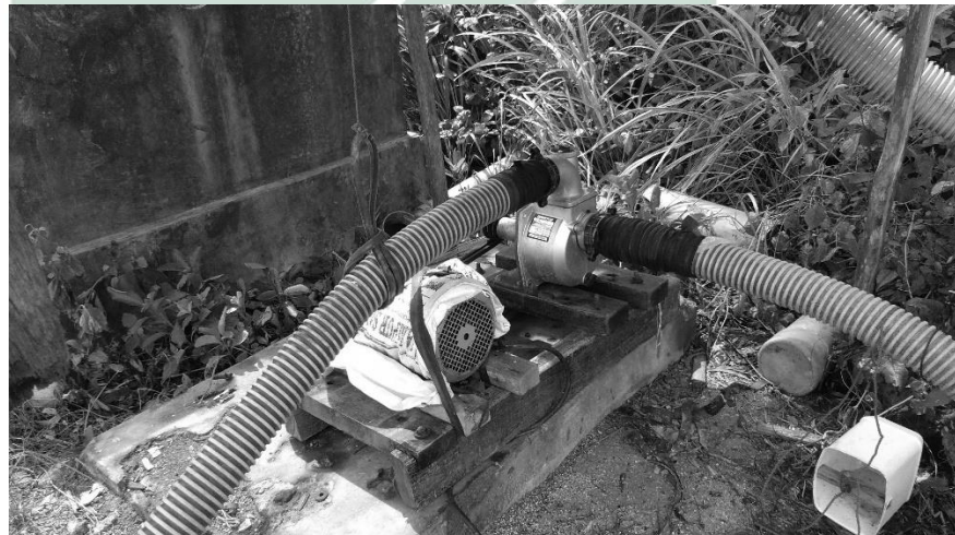
Gambar 3.3 Mesin Pompa Air Dilengkapi dengan Filter
