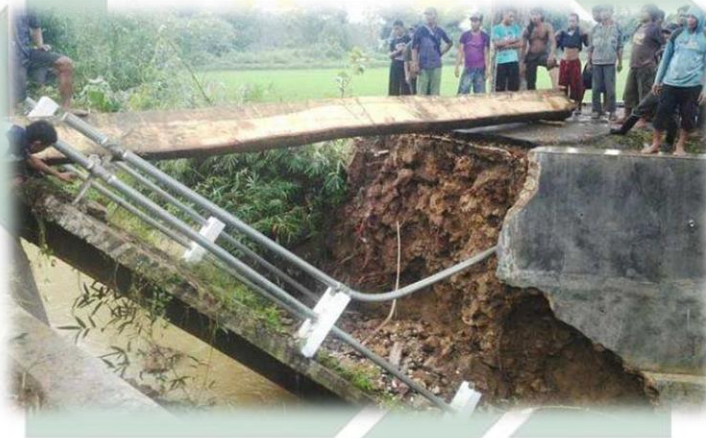
Gambar 5.1 Jembatan Penghubung Antar Desa Putus
