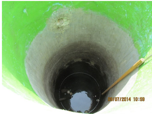
Gambar 7 . Kondisi Sumur “Bubbles” Warga
