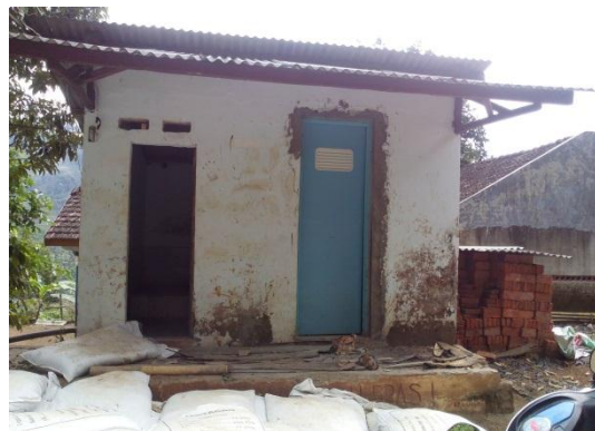
Gambar 1.6 : Toilet yang Mangkrak Dan Tidak Dimanfaatkan
