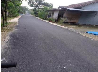
Gambar 5. 5 Kondisi Jalan di Aspal
