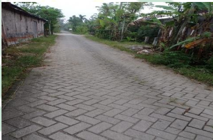
Gambar 5. 6 Kondisi di Paving
