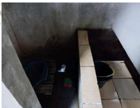
Gambar 3.6 Toilet Setengah Terbuka di Pesantren Raudlotul Falahiyyah
