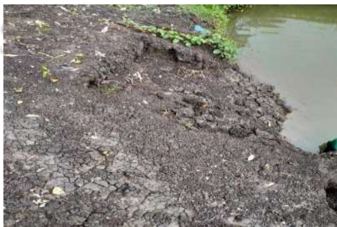
Gambar 4. 3 Tanggul Tanah Tambak yang Longsor
