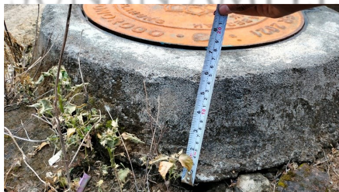
Gambar 5. 19 Kelebihan Tinggi Manhole (MH 9)
