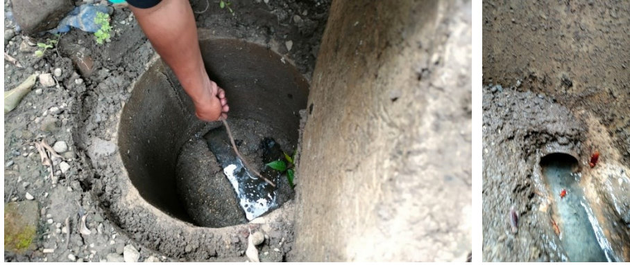
Gambar 5. 18 Kondisi Bak Kontrol Dengan Padatan Didalamnya Sumber: Dokumentasi Penulis (2023)
