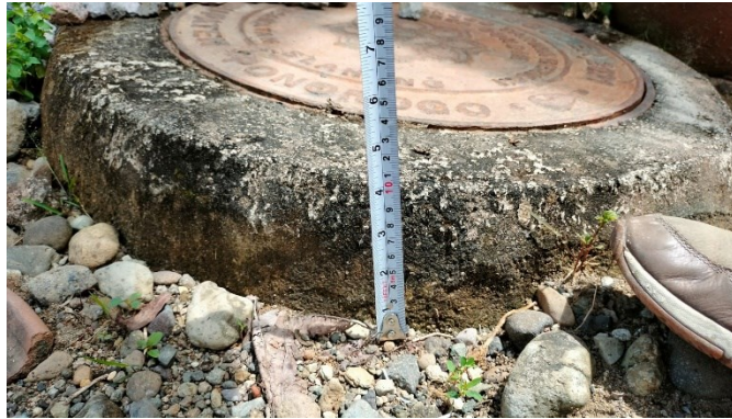
Gambar 5. 20 Kelebihan Tinggi Manhole (MH 16)
