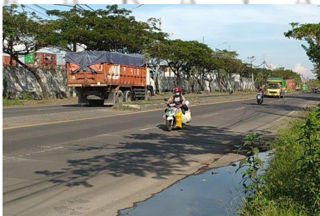
Gambar 4.1 Kondisi Jalan Tambak Osowilangun Surabaya
