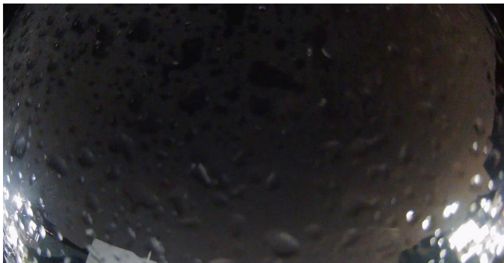
Gambar 4.47 bekas air hujan pada dome
