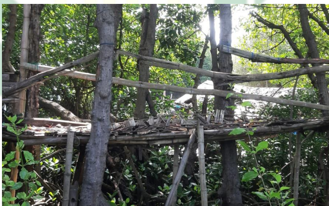
Gambar 4. 13 Jembatan yang rusak di Ekowisata Kalimireng
