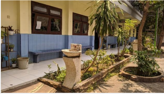
Kran air dan sabun di setiap depan ruang dan kelas
